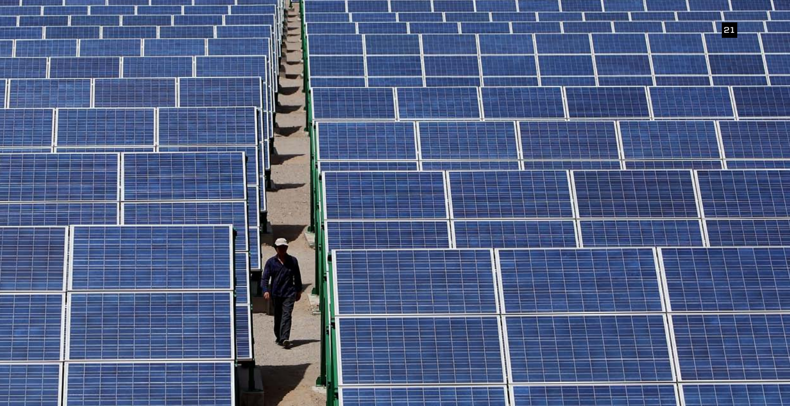
100MW solpanelanlæg i Dunhuang, Kina.
